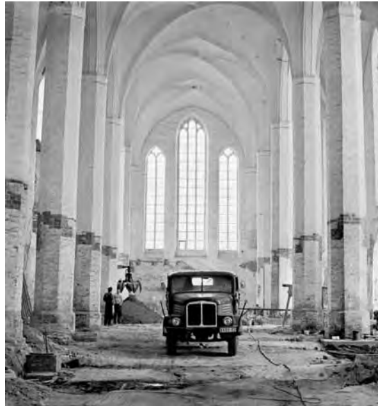
Im Verlauf der Entkernung und Grundsanierung der Katharinenhalle wurde schwere Technik eingesetzt. So stand schon mal ein Lkw im Kirchenschiff.
